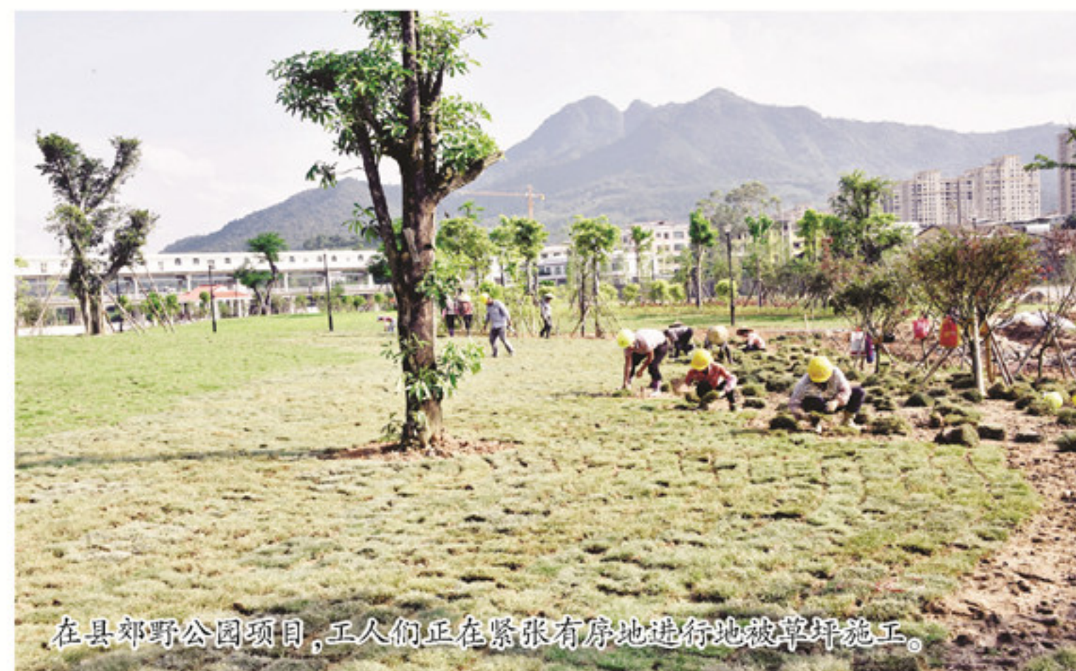
在县郊野公园项目,工人们正在紧张有序地进行地被草坪施工。
